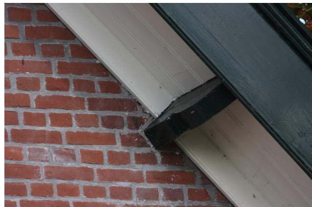
Fig. 46 Aansluiting dakoverstek op gevel na herstel ongeschikt voor vestiging huiszwaluw
